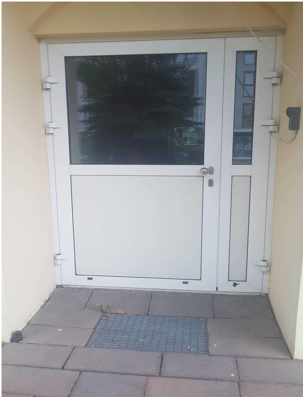
Istniejące drzwi przeznaczone do wymiany. Widok od strony zewnętrznej.
