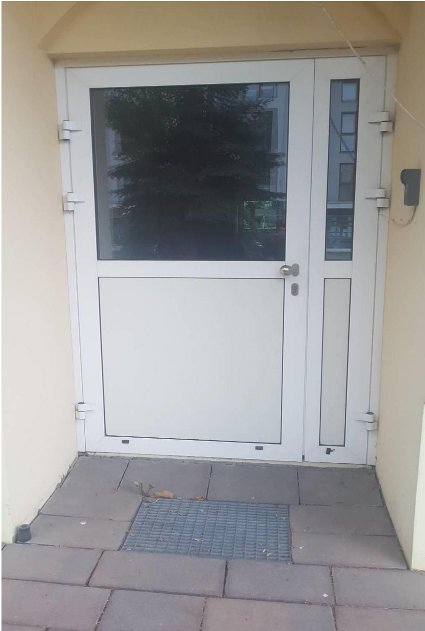
Istniejące drzwi przeznaczone do wymiany. Widok od strony zewnętrznej.
